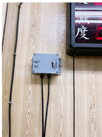
包裝室安裝 溫溼度感測模組
