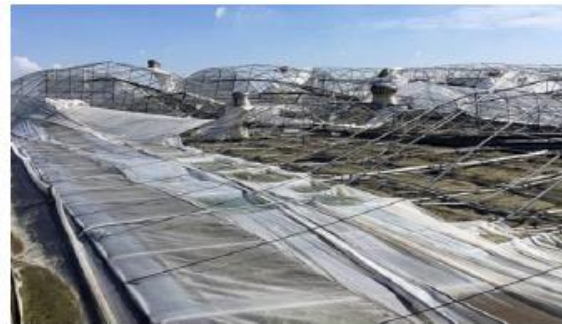
結構管材耐受力等級不足
