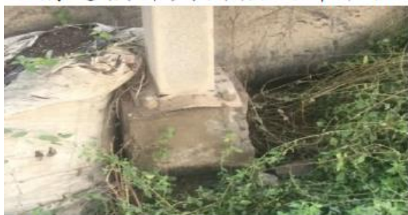
型鋼底板變形
