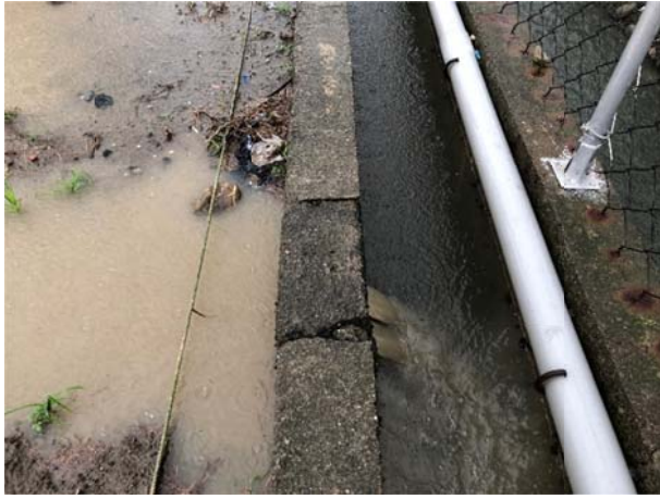
豪雨過後須檢修排水溝渠道設施，以維持排水系統暢通。
