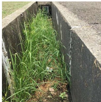
園區排水溝確保順暢，即時清除雜草、殘枝或落果，避免阻塞排水。
