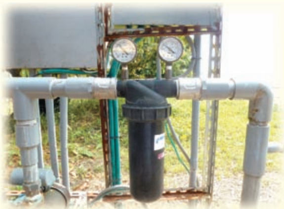
▲圖6.碟式過濾器上有2個壓力表，分別代表進水(左表)及出水壓力(右表)。
