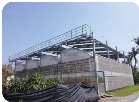
圖1. 屋頂式太陽光電設施
