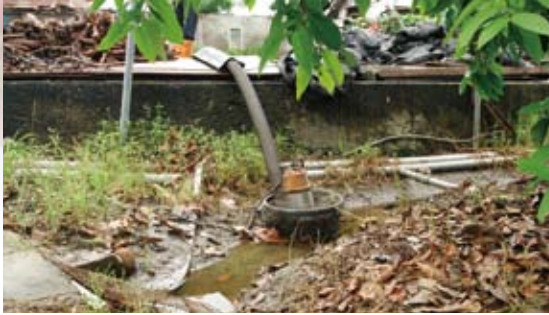
▲圖11、雨季時可利用抽水機加速排水
